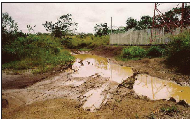
Photo 29 : Deuxième tronçon conduisant derrière le CES Daniel Didier Roguet (Strictement au bout de la barrière du CES, photo prise après la pluie)
