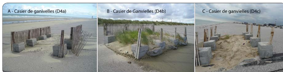
Figure 6.24 Photographies illustrant les détériorations au niveau des structures installées au centre (A & B) et à l'Ouest (C) de la digue du Braek (clichés Tresca, 12.05.2011)
