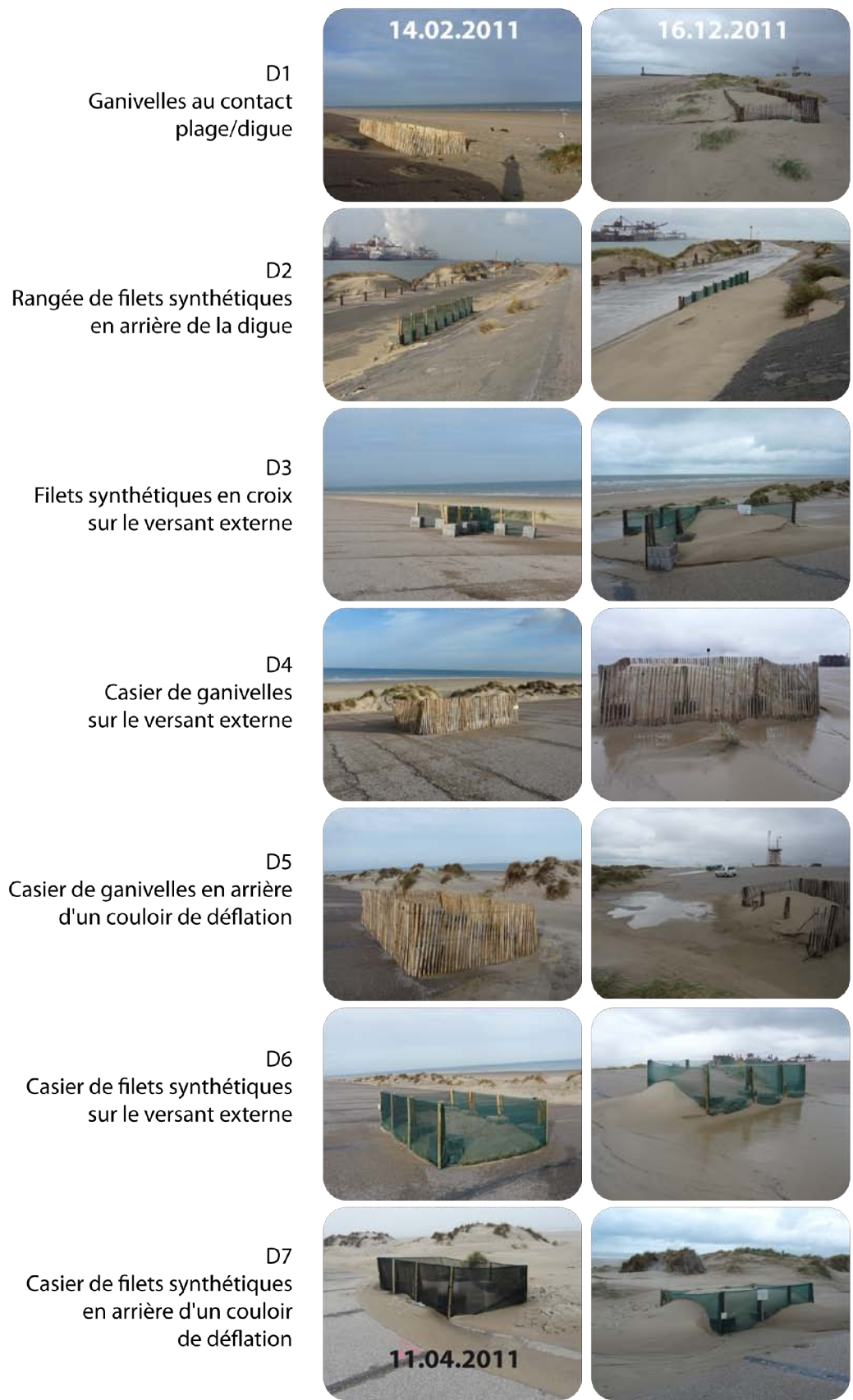
Figure 6.40 Photographies des structures de captage du sable installées en arrière des dunes de pied de digue le 14.02.2011 (11.04.2011 pour D7) et le 16.12.2011 (clichés Tresca)
