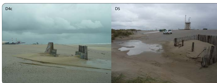
Figure 2.7. Illustration des dégâts causés à certaines structures, ici au niveau de D4c et D5 (Photographies Tresca 16.12.2011)
