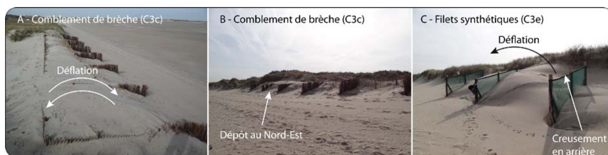
Figure 6.14 Photographies de la structure de comblement de brèche (C3c) (A & B) et des filets synthétiques (C) illustrant la déflation au dessus des structures (clichés Tresca, 11.04.2011)
