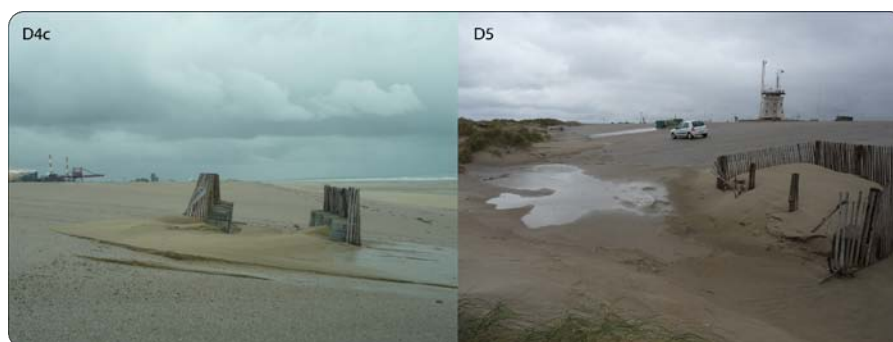
Figure 2.7. Illustration des dégâts causés à certaines structures, ici au niveau de D4c et D5 (Photographies Tresca 16.12.2011)
