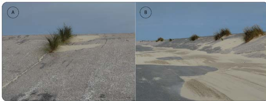
Figure 3.21. Photographies de la naissance de dunes sur la digue par l'exploitation des fissures dans l'enrobé (Clichés, Tresca, 28/07/2010)
