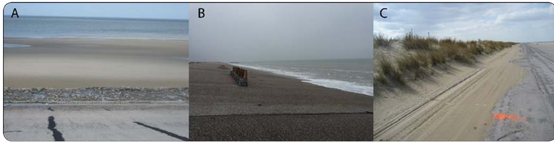
Figure 7.14. Au niveau du profil D3 (centre de la digue) à marée basse 22.03.2010 et marée haute le 21.02.2011, et dépôt au pied de dunes de sommet de digue le 22.03.2010
