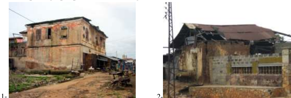
1- Rue du quartier Agbokomey - 2006. 2- Habitation aux toits et murs en état de décomposition avancée - Quartier Zinkimey – 2006. (Clichés Charles-Dominé J.)
