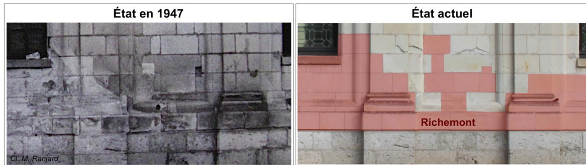
FIGURE 64 : DESQUAMATION EN PLAQUES SUR L'AILE SUD - FAÇADE SUR JARDIN
