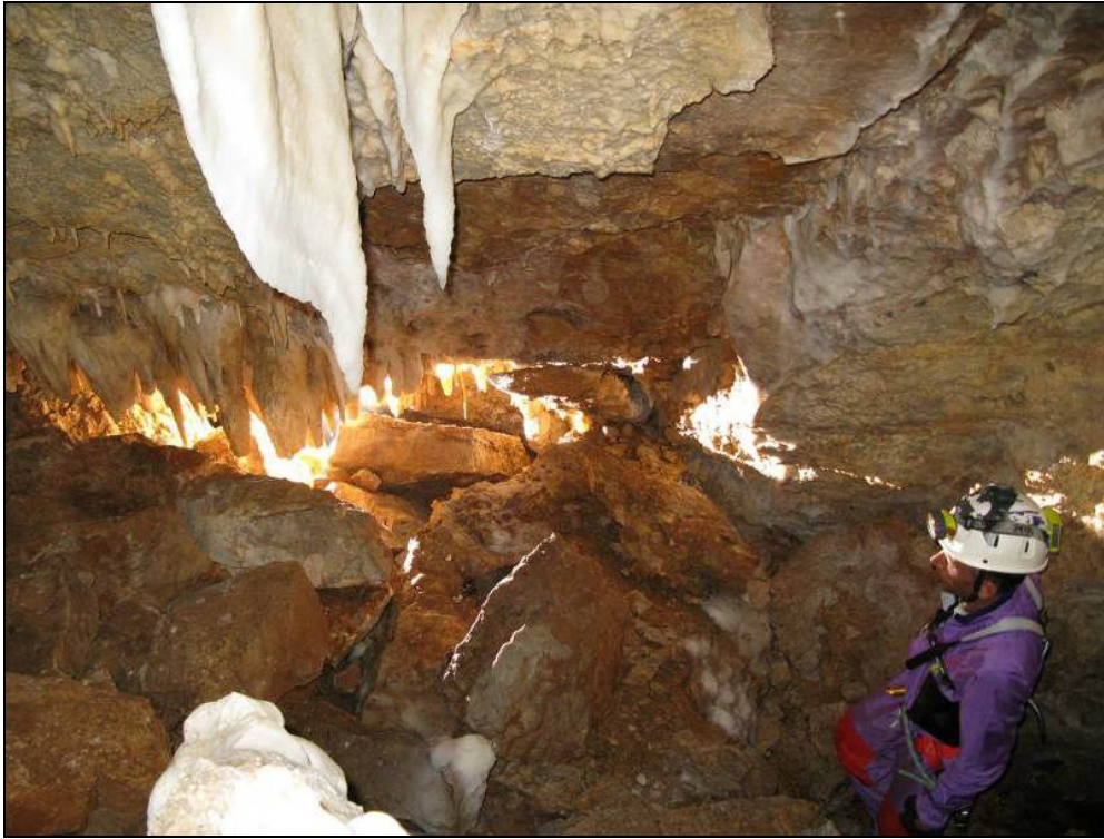
Figure 8.6. Au niveau de l'entrée de la « Galerie des Soutirages », le long de la paroi nord, des strates calcaires se détachent de la paroi (Cliché B. Jabbour Gédéon).
