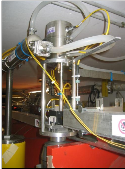
Figure 1-8 : Installation HLS et WPS sur les Low-Beta
