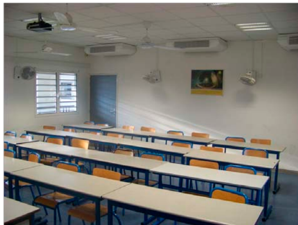
Figure II-26 : Salle d'enseignement avec ventilo-convecteur et brasseur d'air
