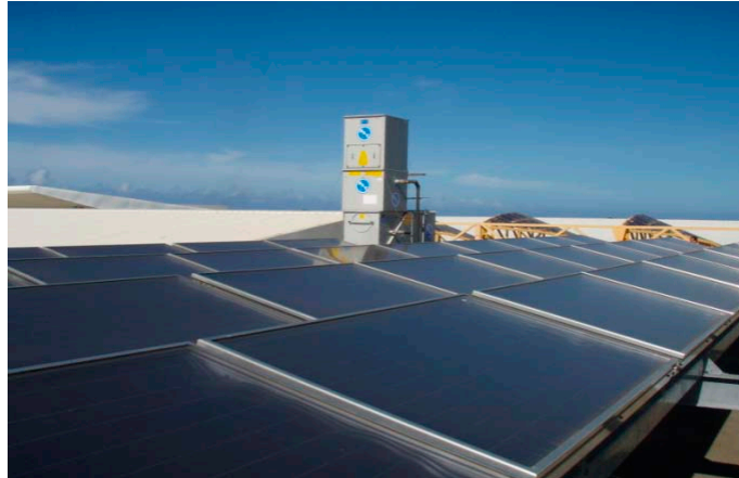
Figure II-20 : Champ de capteurs solaires double vitrage de 90 m 2
