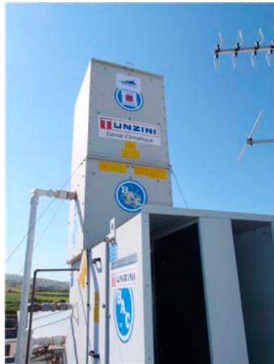
Figure II-25 : Tour de refroidissement ouverte
