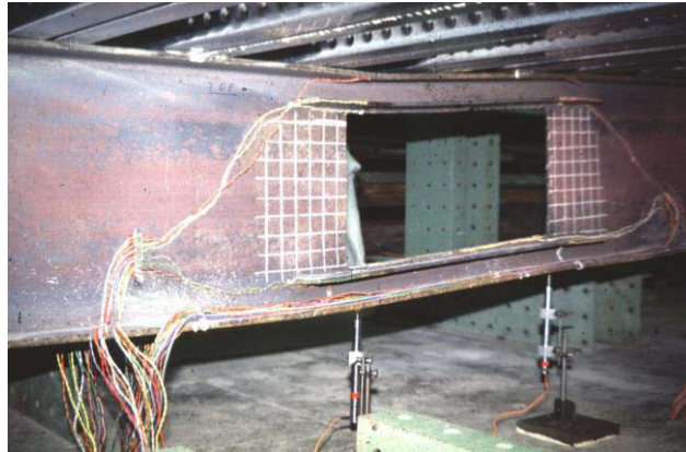
Figure I-21 Flexion Vierendeel dans l'essai d'une ouverture de grande dimension avec raidisseurs horizontaux
