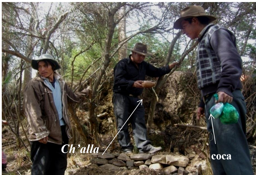
Photo 225 Régulièrement des pauses sont faites dans le travail. Ici, après la construction d'un muret de contention, on p'iqchea et on fait une ch'alla .
