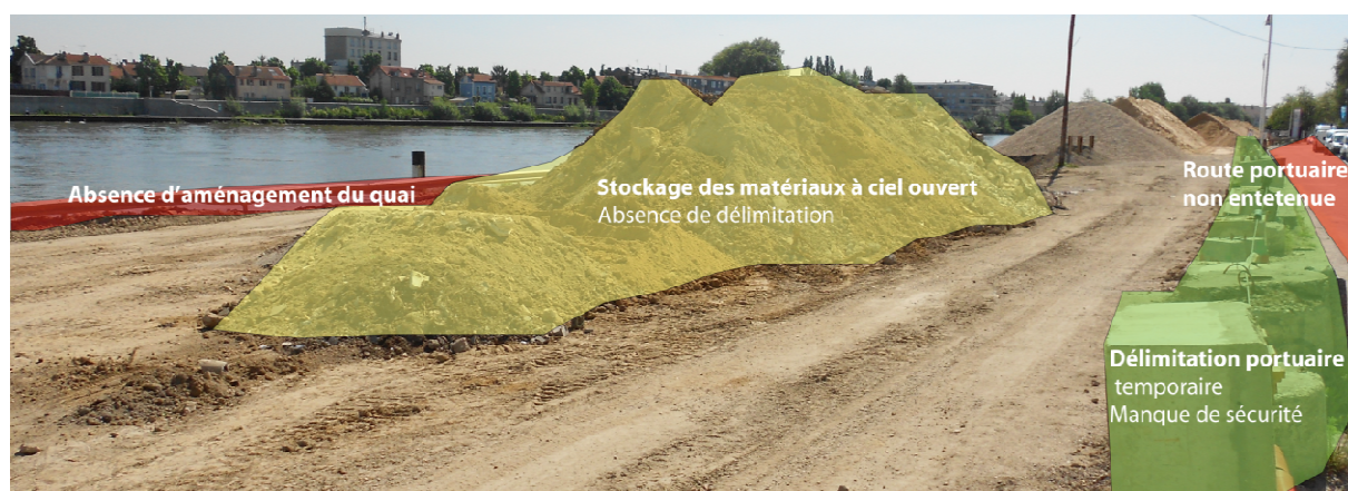
Figure VI-3. Le manque d'aménagement du site portuaire de Choisy-le-Roi
