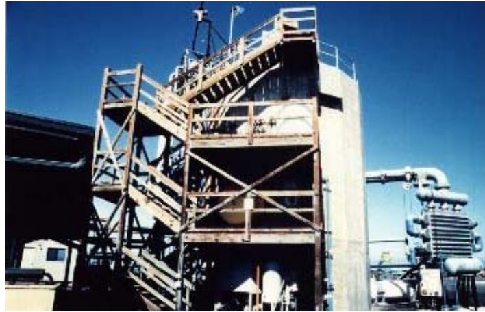
Figure I-14 : La plus puissante centrale expérimentale à cycle ouvert de 210 kW.
