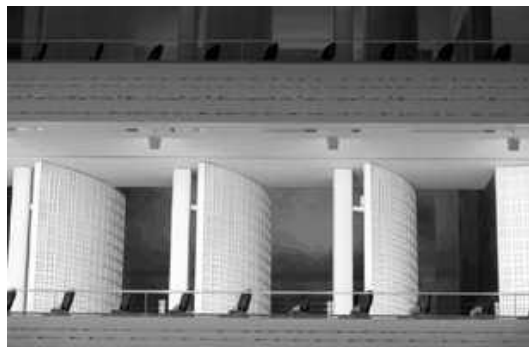
FIGURE 1.4 – Détail de portes entre la salle principale et la chambre de réverbération au niveau d'un balcon, dans la salle du KKL à Lucerne en Suisse.
