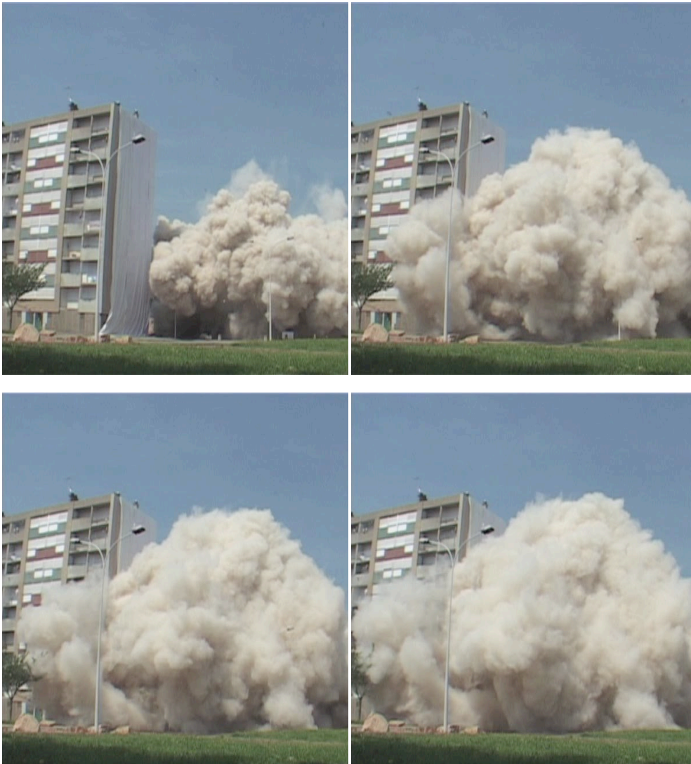
Figure 53 : Evolution des structures turbulentes au cours du temps. Site de Mâcon 2
