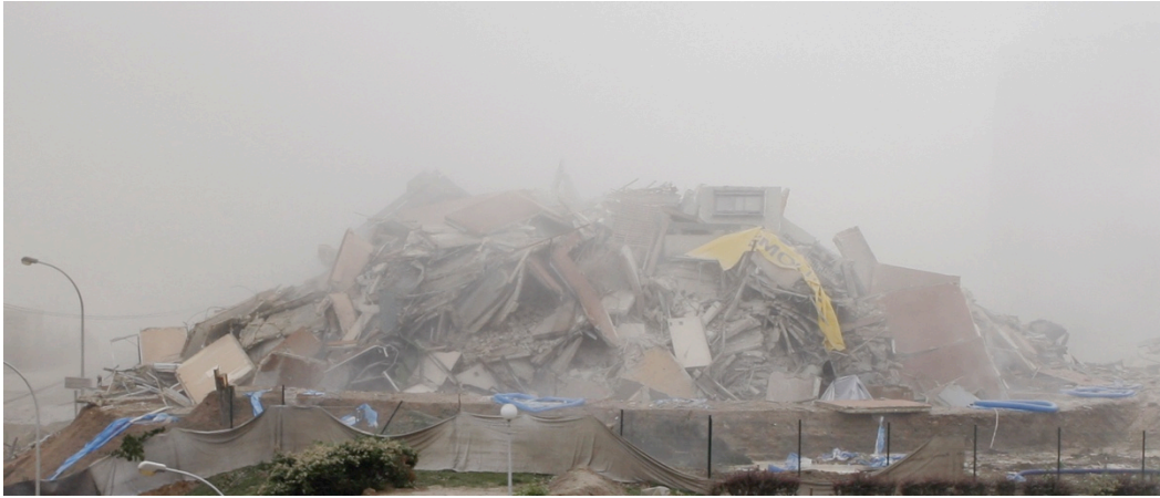
Figure 43 : allure typique d'un tas (bâtiment 251 Dammarie-les-Lys)
