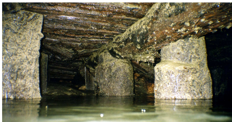
Figure I-9. Exemple de détérioration du platelage en hêtre sous les quais du Grand Port Maritime de Rouen
