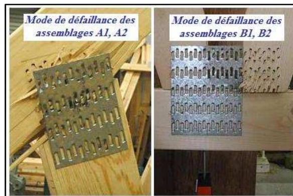
Figure III. 13 : Modes de défaillances observés au niveau des assemblages de la fermette en bois [139]
