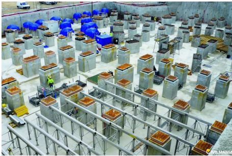
(b) Appuis parasismiques réels, Cahiers, 2011
