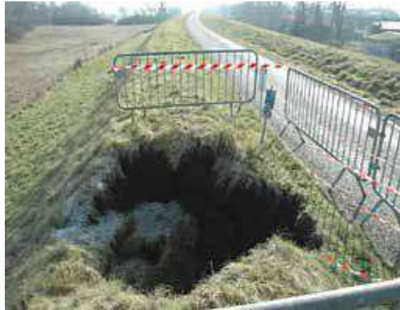
Figure 114 : Fontis observé sur la commune de Jargeau (Géosciences, BRGM), correspondant à l'effondrement des terrains surmontant la voûte d'une cavité karstique
