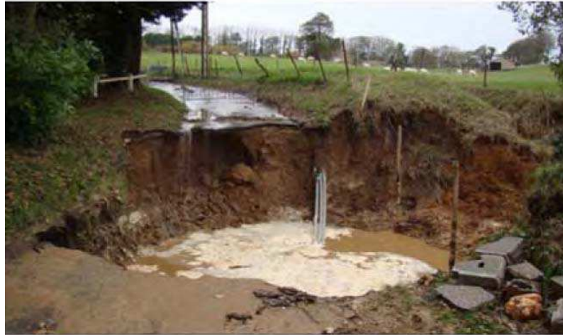
Figure 1.9: Exemple de risque d'effondrement d'une béttoire au niveau d'une route à Saint Jouin de Bruneval, observations BRGM du 06/11/2009.
