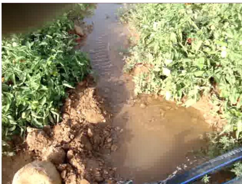
Figure 17. Pertes d'eau sur les portes rampes d'un réseau en goutte à goutte
