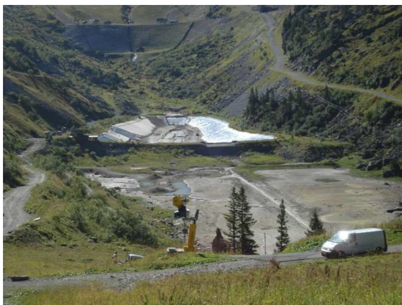
Figure. 92 Aménagement du lac 1730 avec la pose de bâches étanches sur le second bassin. (Cliché : Juillet 2010, E. Magnier).
