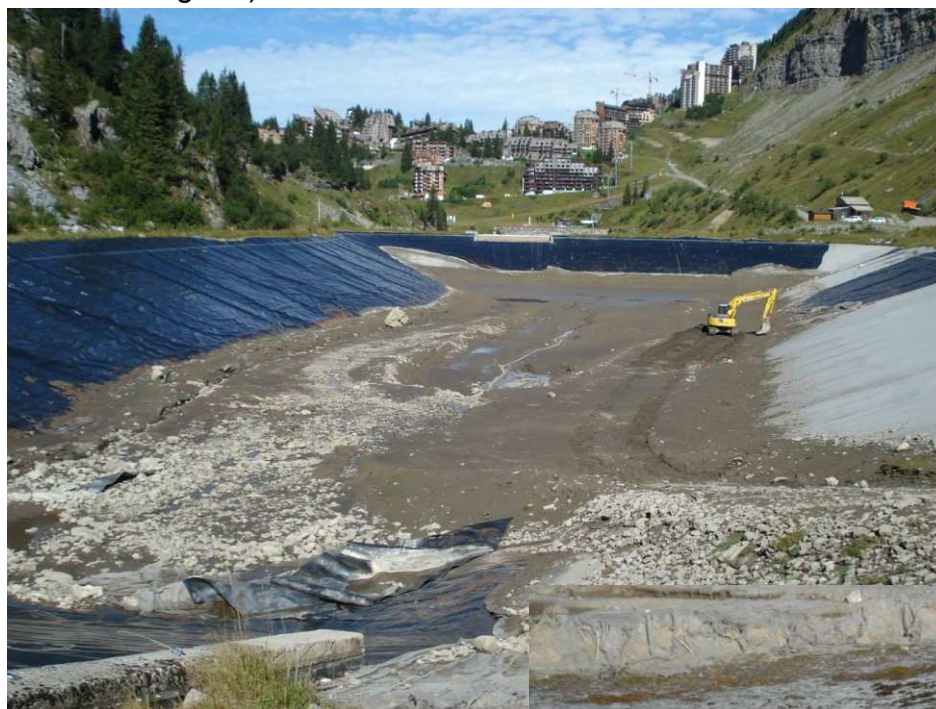
Figure. 137 Lac vidangé pour réparation de la bache de fond. (Cliché : 2 juillet 2011. E. Magnier).
