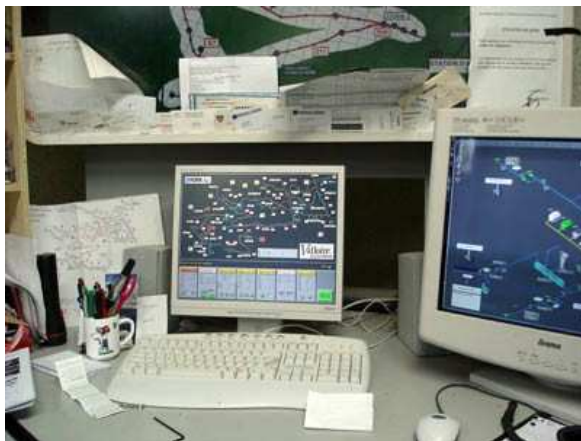
Figure. 31 Poste de commande sur le secteur de la Setaz, station de Valloire. (Source : http://www.ski-valloire.net/dossier/neige.php ).
