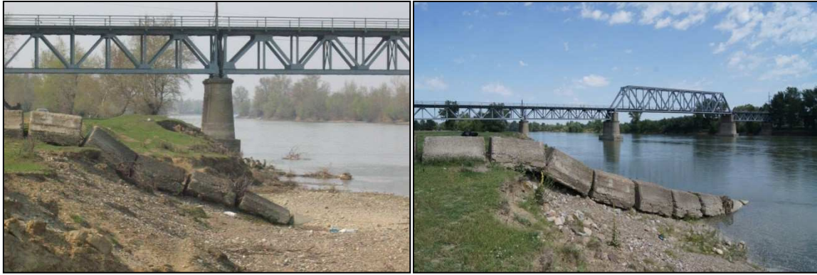
Figure 3- 54: Estimation du recul de la berge en rive droite du Siret à l'aval du pont de la voie ferrée de Suraia. En avril 2009 (à gauche) 4 blocs effondrés depuis la construction de l'épi (1970's) ; en juin 2012 (à droite) 3 blocs supplémentaires, soit une érosion de 6 mètres entre ces deux dates. (Photographies: F. Salit) (Localisation Figure 3- 48)
