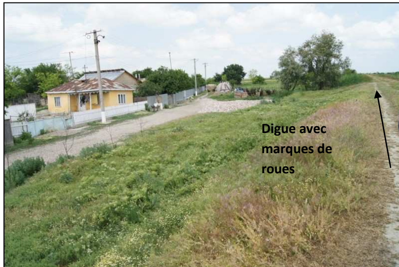
Figure 2- 19: Digue fragilisée à Belciugele. La digue a rompu en juillet 2005. (Photographie : F.Salit, juin 2011)
