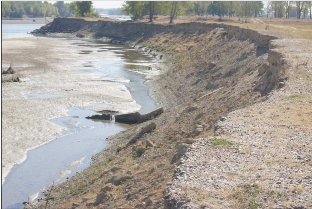
Figure 3- 53: Erosion de la berge en rive droite du Siret à hauteur de Biliști, vu vers l'aval. Sept blocs de l'épi au centre de la photo sont détruits: environ un recul de berges de 14 mètres (Photographie : F. Salit, octobre 2011) (Localisation Figure 3- 48)
