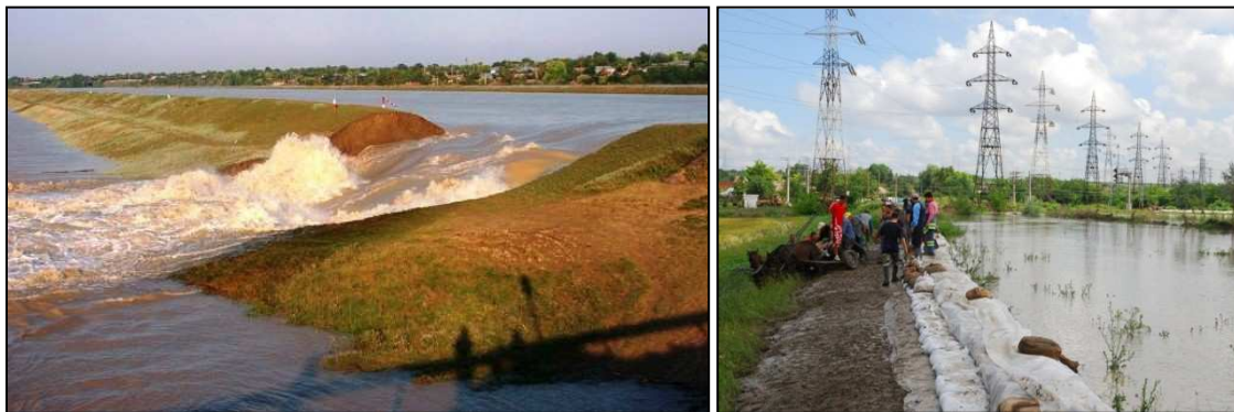
Figure 2- 20: Brèche dans une digue sur la rivière Suhu à Piscu en juillet 2005-jud Galați (à gauche). Consolidation d'une digue avec des sacs de sable à Șendreni en 2010 (à droite) (Photographies : ANAR)
