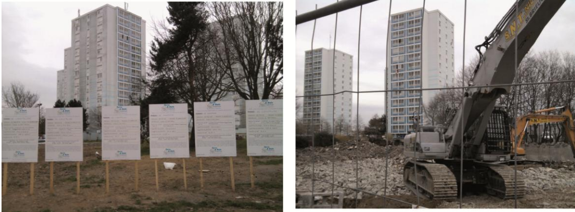
Les sites de la reconstruction à La Croix-Lambert au moment de la mise en chantier des opérations de démolition des tours, 7 février 2011
