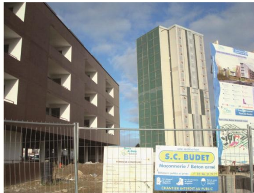
Enveloppement de la tour après un incendie volontaire le 3 avril 2012 Saint-Brieuc, juin 2012
