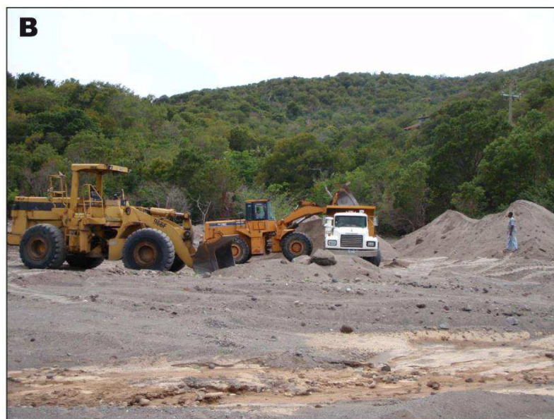
Figure 167 – Corridor de lahars et extraction des dépôts volcanoclastiques à Montserrat. A : Le corridor de lahars de la Belham, à l'ouest de Montserrat (cliché H. Odbert, 2011). B : techniques d'extraction par tractopelles, lesquelles ne sont pas utilisées au Merapi (cliché M. Froude, 2011).
