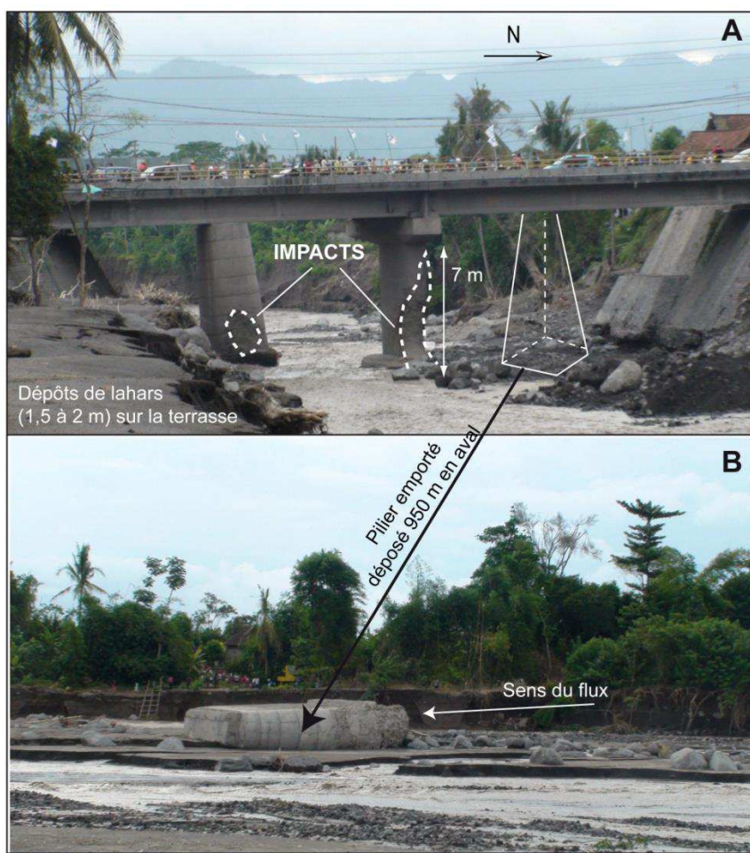
Figure 39 – L'endommagement des piles des ponts de Tamanagung après le lahar du 30 mars 2011.
