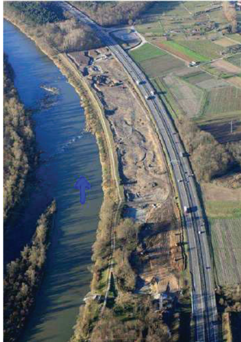
FIGURE 1.15 – Photographie aérienne des travaux de décaissement IRP dans la section I. La flèche bleue indique le sens d'écoulement (Source : Regierungspräsidium Freiburg)
