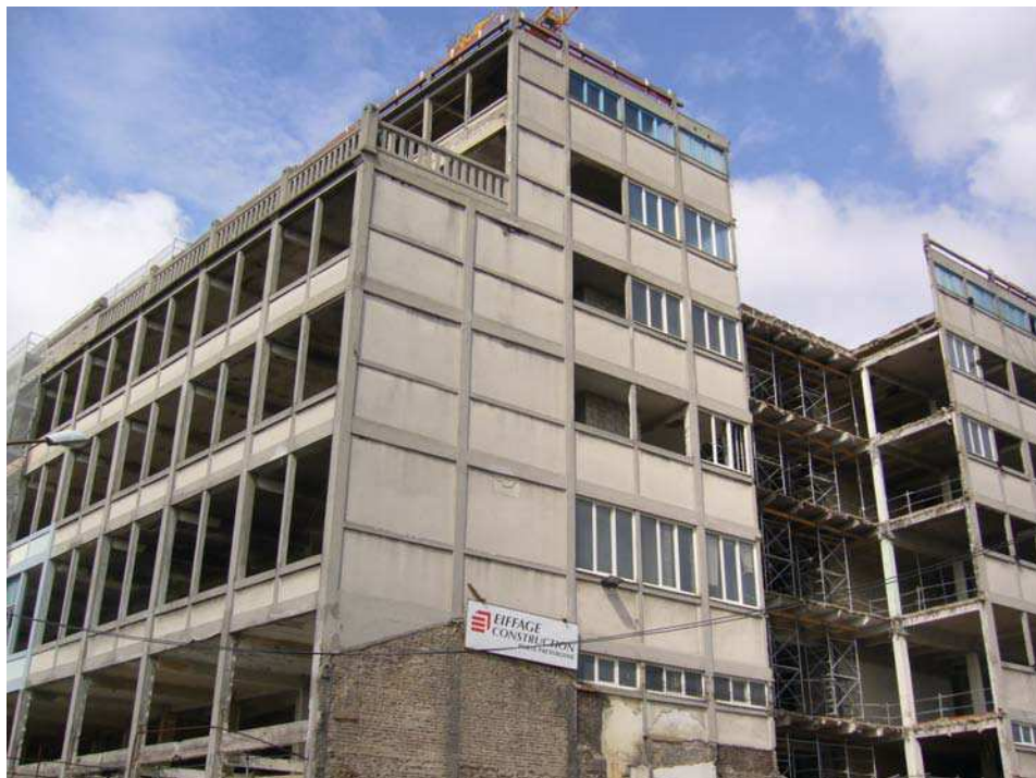
Figure 5-4 : L'ancienne usine Dumas, devenue CAP 1, en travaux pour accueillir le siège de Groupama (mai 2008)
