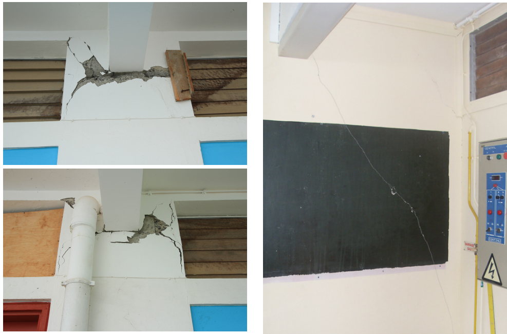
FIGURE 2.2 – Dommages observés dans le collège Gérard Café du Marin, causés par le séisme du 29 novembre 2007 ( M_W = 7.4 ). A gauche : fissuration en X ; à droite : fissuration d'un mur de remplissage.
