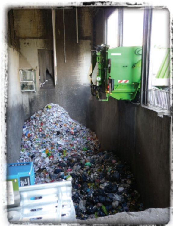
(a) Réception des déchets ménagers
