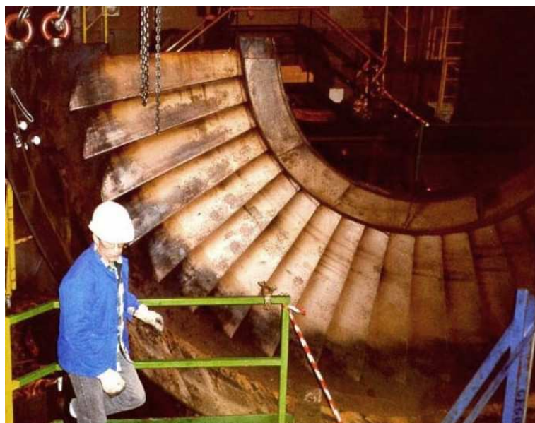
Figure 3.1.: Vue d'une partie du stator d'une turbine du parc Nucléaire
