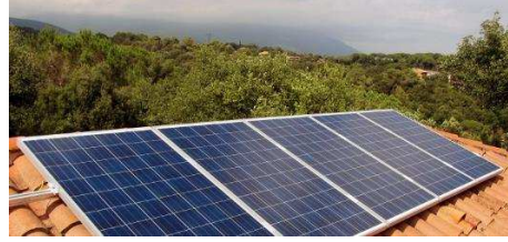
FIGURE 1.9 – Exemple d’installation domestique de panneaux photovoltaïques
