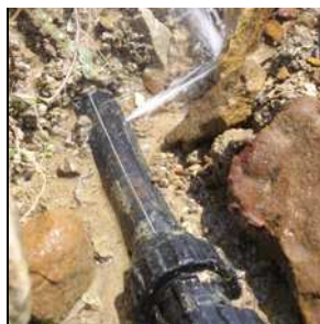
Fuite d'une adduction d'eau
