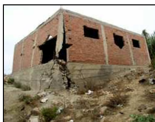
Photographie 4. Maison fissurée à Tétouan (quartier Korret Sbaâ, 2003)
