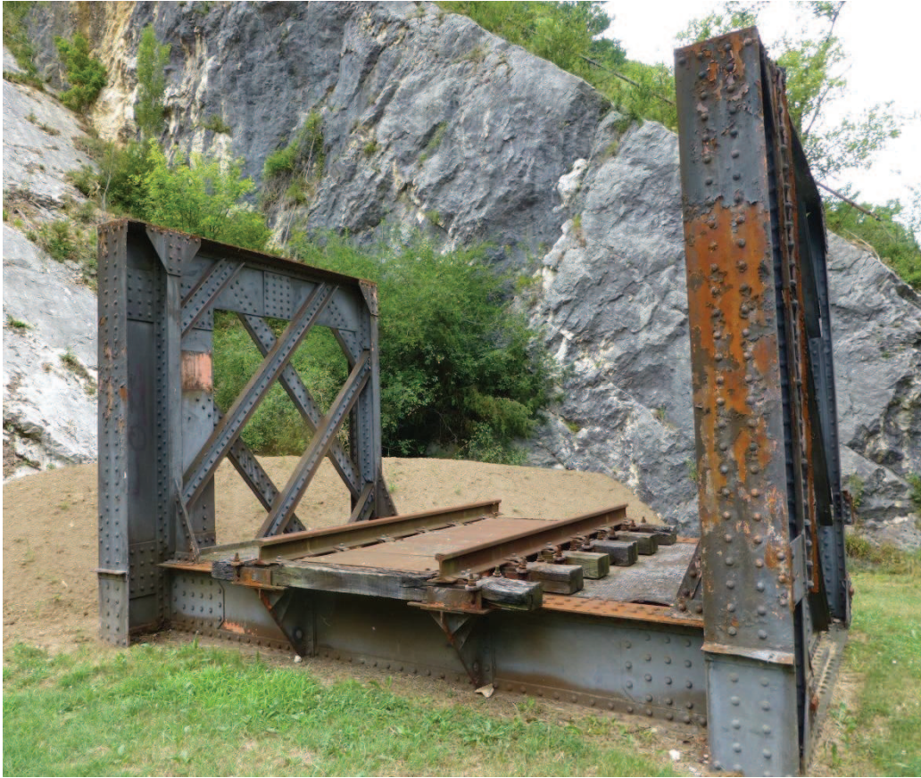
Photographie 36. Morceau de travée du tablier à voie unique en fer puddlé du pont ferroviaire sur le Rhône, conservé par la commune de Vions (E. Cottet Dumoulin, juillet 2013).
