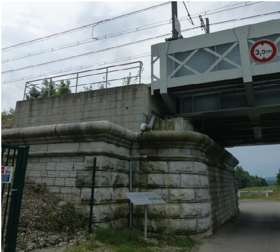
Photographie 37. Culée du pont ferroviaire sur le Rhône rive gauche (E. Cottet Dumoulin, juillet 2013).
