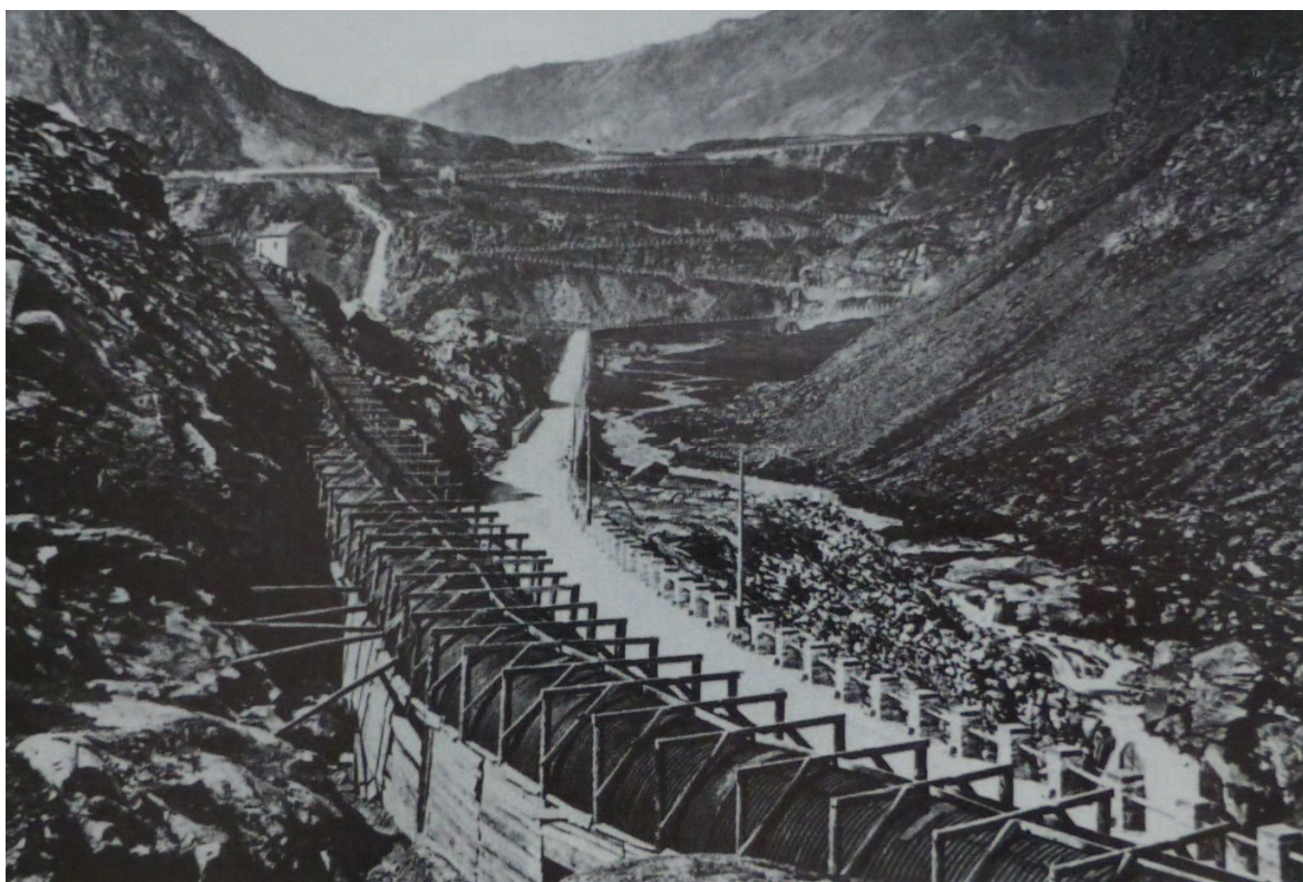
Photographies 38 a et b. Galerie artificielle en bois et en tôle au Piano San Nicolao (dans E. PIERI, La ferrovia del Moncenisio ed il sistema Fell ad aderenza artificiale , Sant'Ambrogio, Susalibri, 1996, p. 35).
