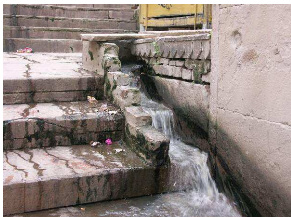
Évacuation d'eaux usées domestiques le long d'un ghât Assi Ghât, Varanasi, 17 août 2007
