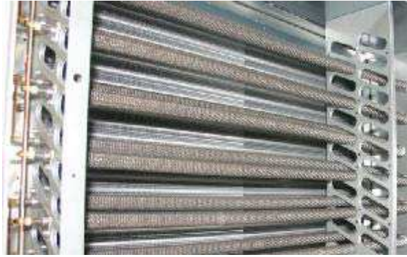
Figure 2.8. Batterie d'Appoint de Régénération électrique (BAR)
