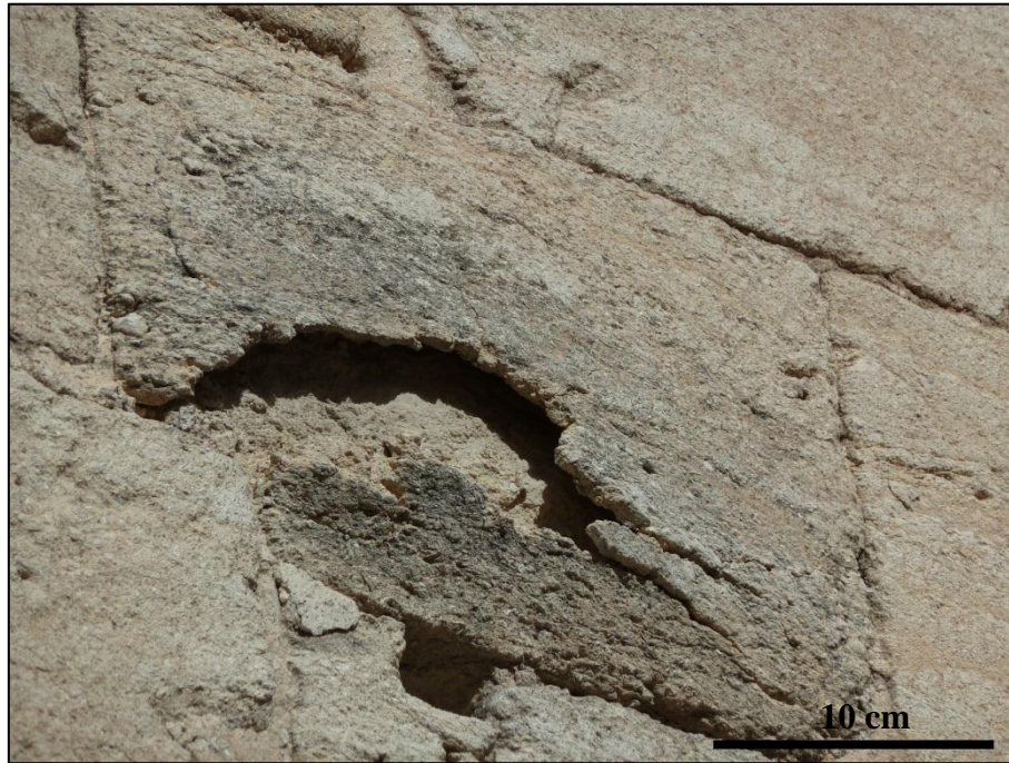
FIGURE II-13. Cliché photographique d'une assise touchée par le phénomène de desquamation en plaques sur la façade sud de l'église Notre Dame de Grace (XIIe, Barbentane, 13).
