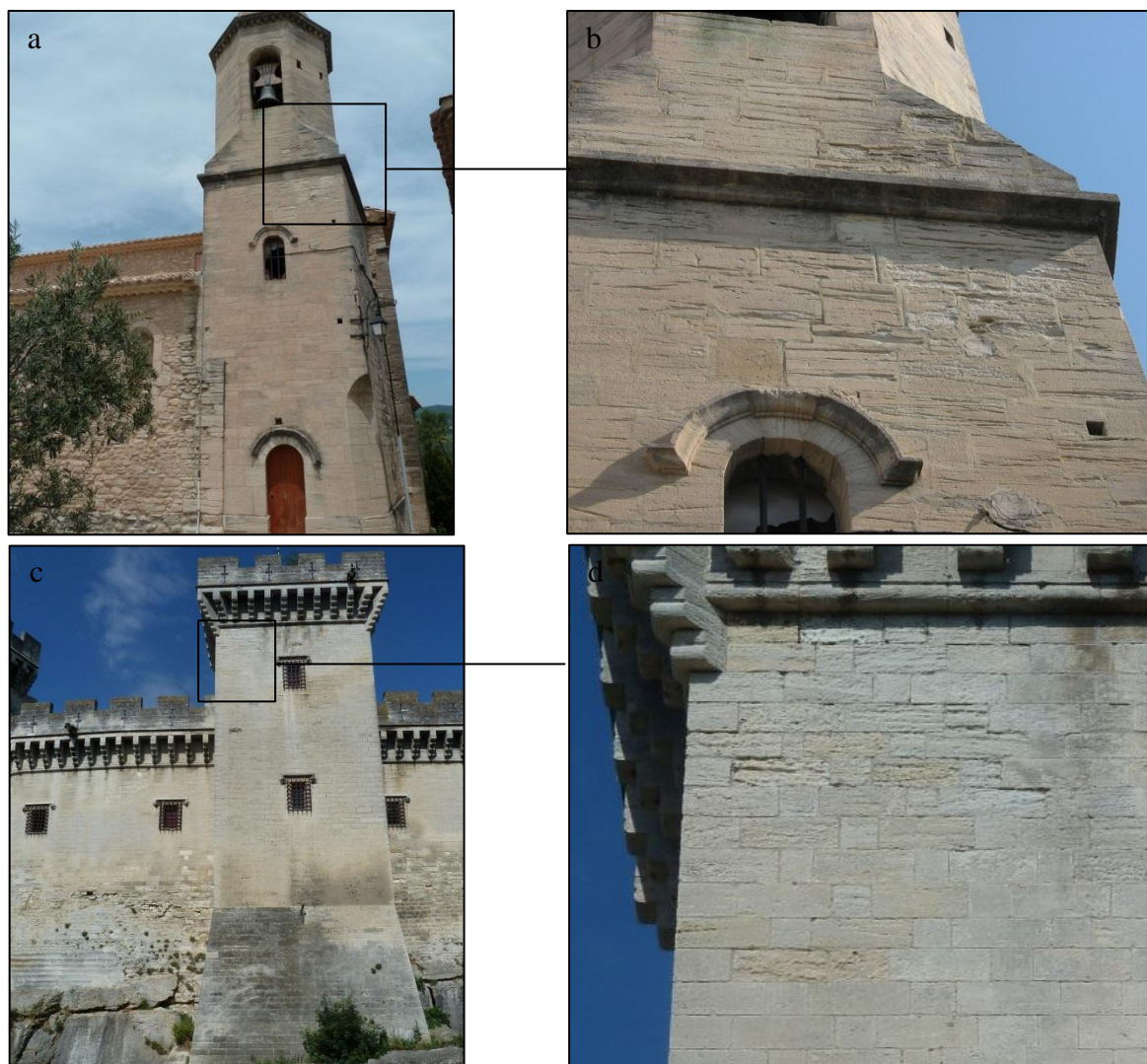
FIGURE II-14. Clichés photographiques des monuments historiques illustratifs du degré de desquamation intermédiaire. Avec (a) et (b) : l'église Saint Romain (XIVe, Crillon-le-Brave, 84) ; (c) et (d) : le château de Tarascon (XVe, Tarascon, 13).
