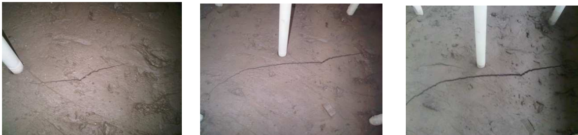
Augmentation de la longueur de la fissure au cours du temps
