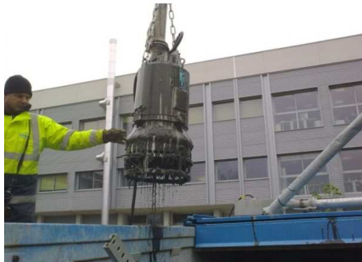
Figure III-10 : Pompe bouchée par des algues et des cordelettes
