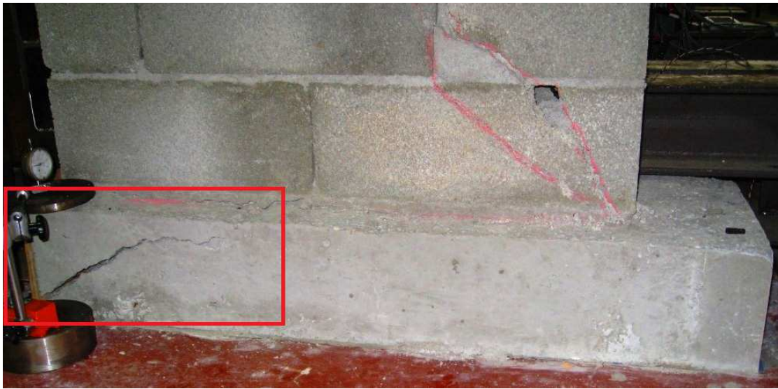
Fig. 2.71. Grande fissure au niveau de la semelle
