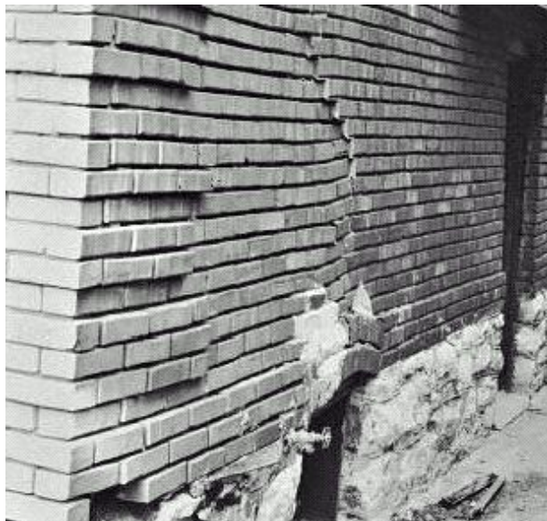
Figure 1.1 – Rupture fragile d'une structure maçonnée.
