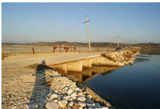
Figure 97 : Vanne de puisage de l'eau de la lagune vers les marais salants (clichés J. Parnaudeau).
