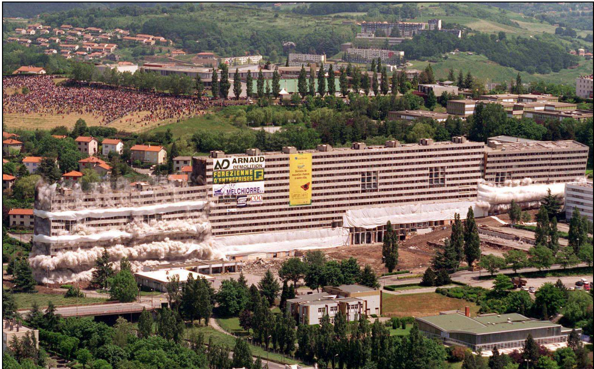
Image 36 : Saint-Etienne, 27 mai 2000, 13h : la Muraille de Chine s'effondre.
