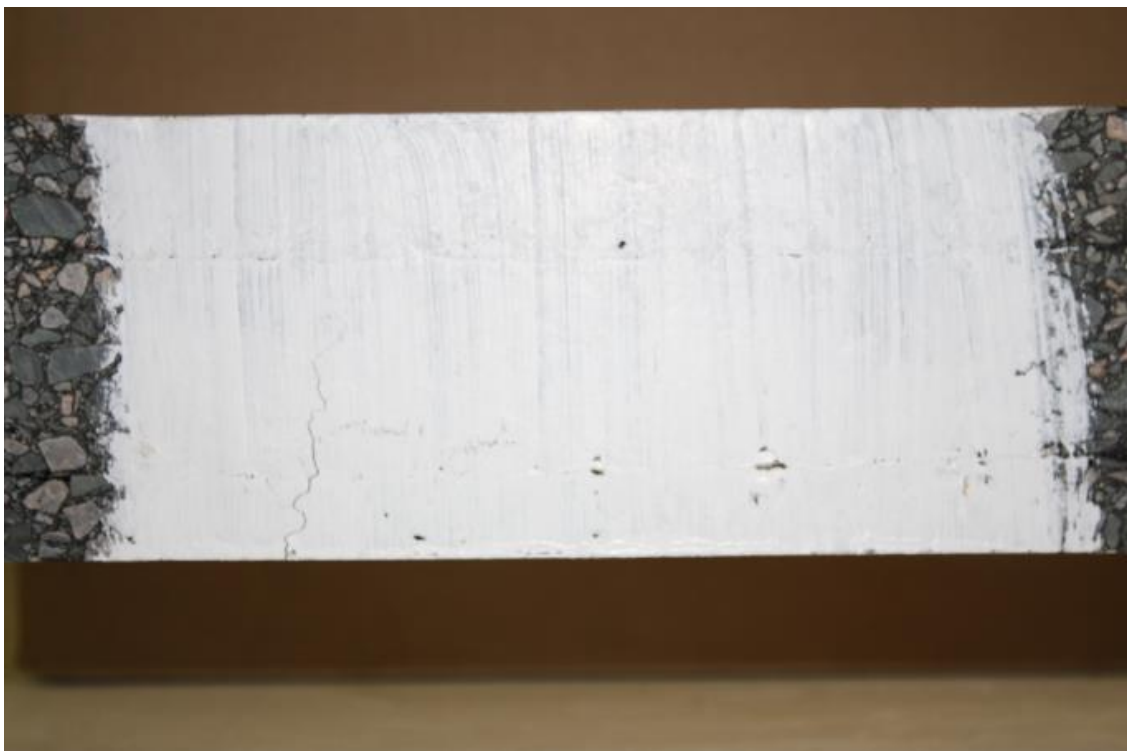
Figure 4.30 Etat de fissuration à 0h de flexion de la poutre 15R, post essai de fatigue à \epsilon = 129 \mu\text{m/m}
