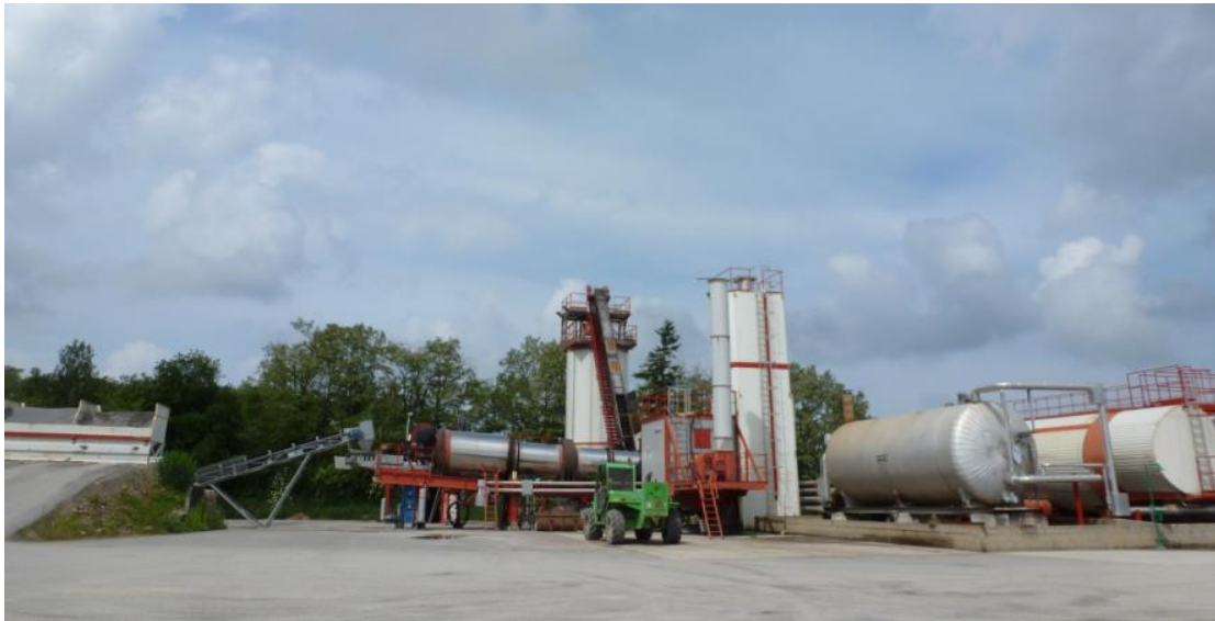
Figure 2.1 Centrale d'enrobage fixe à Certines (photo I.A)
