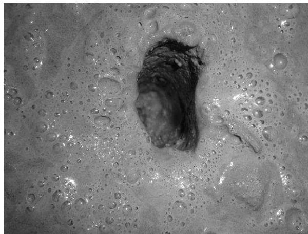
Figure 1.24. Trou non rebouché laissé après extraction d'une aiguille vibrante dans un matériau cimentaire.
