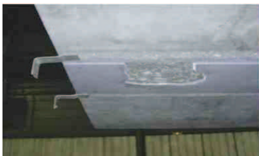
(a) Rupture à l'interface adhésif acier
