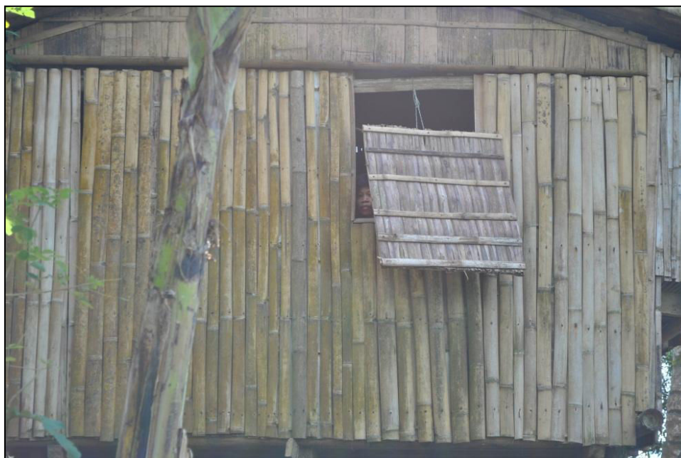
Figure 107 : Les murs en bambou présentant une technique avancée de couture (J. Cadag, décembre 2011)
