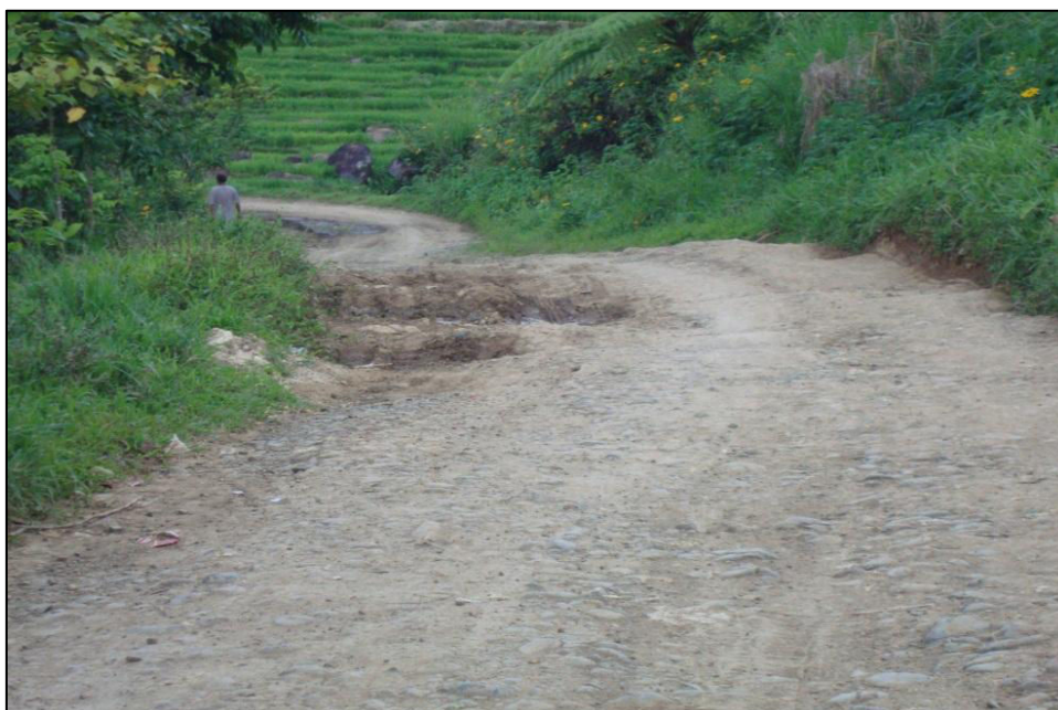
Figure 42 : L'état des nombreuses routes dans les quartiers montagneux du village de Codcod – seules voies d'accès aux hautes terres pour les Bukidnons (J. Cadag, février 2011)
