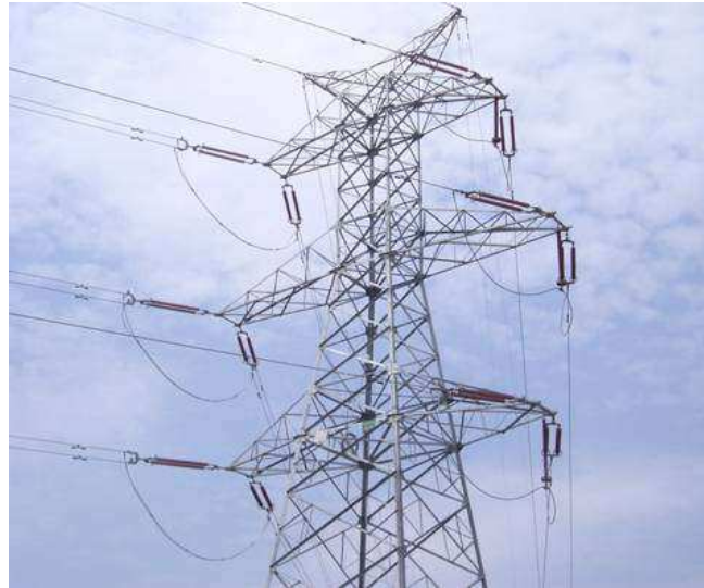
Figure 1. 1. Isolateurs composites sur une ligne électrique 220 kV
