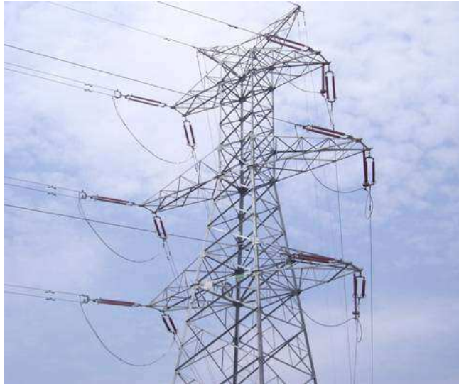
Figure 1. 1. Isolateurs composites sur une ligne électrique 220 kV
