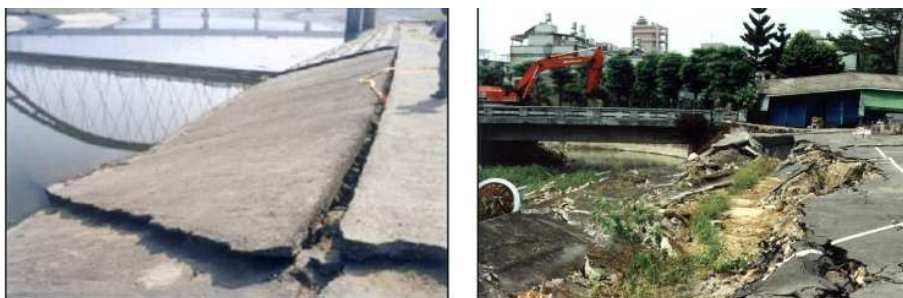
FIGURE A.8: Dommages dus à l'épandage latéral du sol en place
