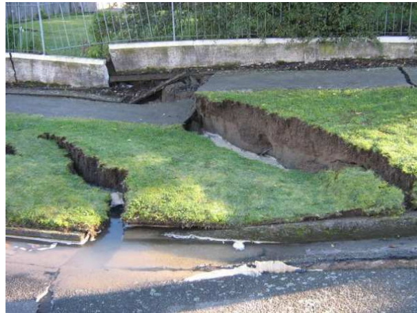
FIGURE 1.4.4: Rupture superficielle et liquéfaction après le tremblement de terre de Christchurch, Nouvelle Zélande (2011)
