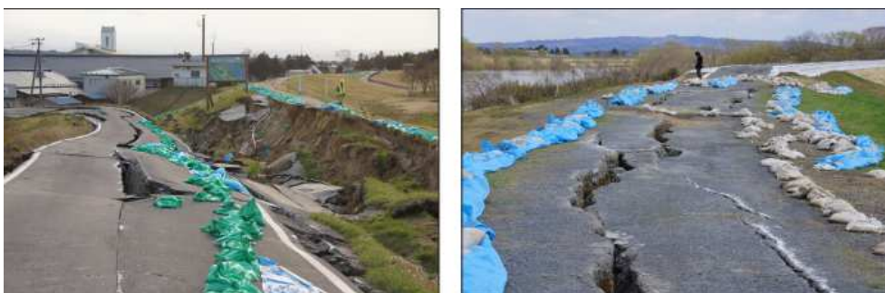
FIGURE 1.4.6: Endommagement des routes : Baisse du niveau de la route due à l'épandage latéral sous l'effet de la liquéfaction du séisme de Tohoku 2011
